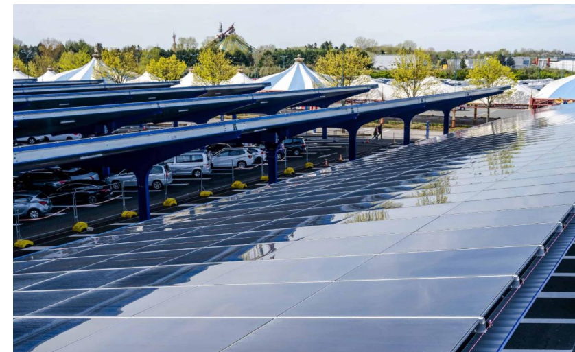
Panneaux Photovoltaïques implantés sur les parkings de Disney – source : https://www.disneylandparis-news.com/
